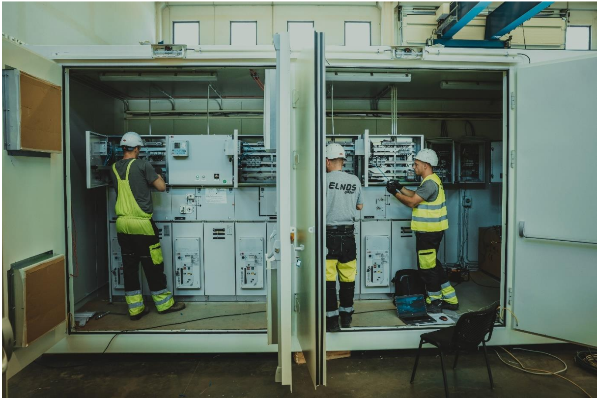
Slika 2: U svakoj od distributivnih stanica ugrađena najsavremenija rješenja
